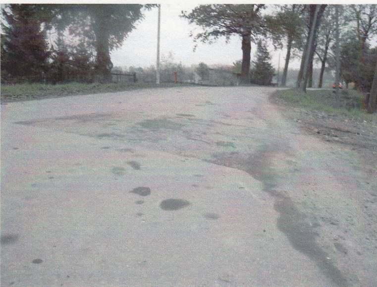
Foto nr 4 ul. Mysłowicka – garb na jezdni.
