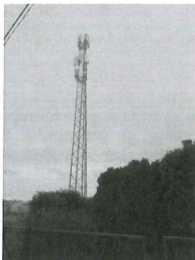
Widok obiektu wraz z zainstalowanym zespołem antenowym
