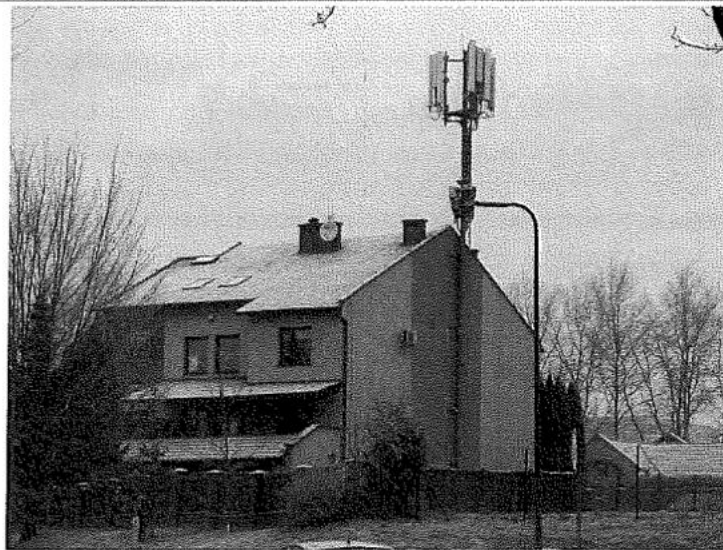
Zal. nr 1: Widok ogólny instalacji radiokomunikacyjnej.
