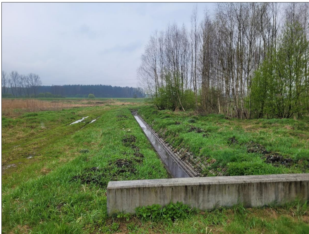
FOTOGRAFIA 3. DRUGI Z KANAŁÓW ŚCIEKOWYCH – WYPEŁNIONY WODĄ – KORYTO W BETONOWYCH PŁYTACH AŻUROWYCH (MARZEC-KWIECIEŃ 2023 R.)
