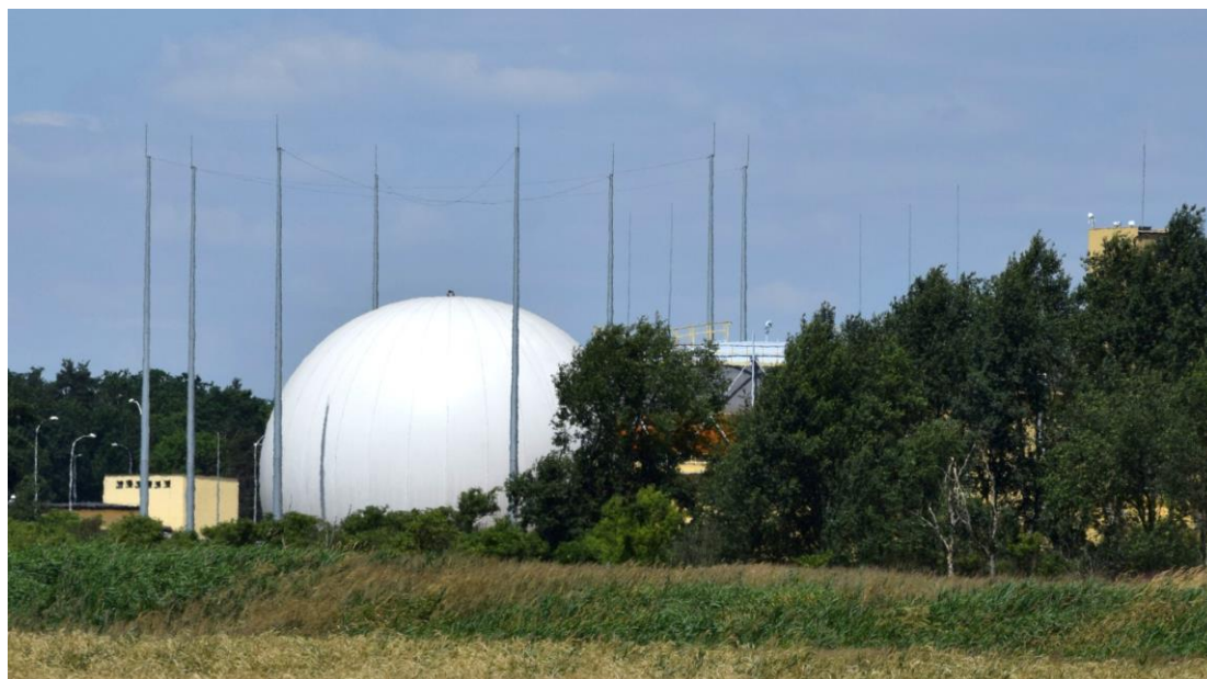
Fotografia 11 Zbiornik na biogaz przy oczyszczalni ścieków (fot. M.Rolka)
