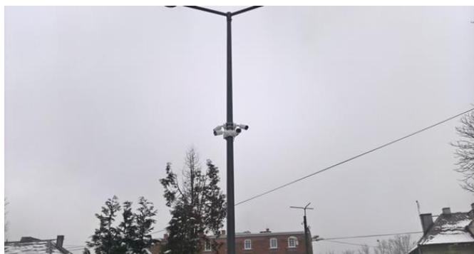
Fot. Zainstalowany monitoring (mat. MZBM Tychy)
