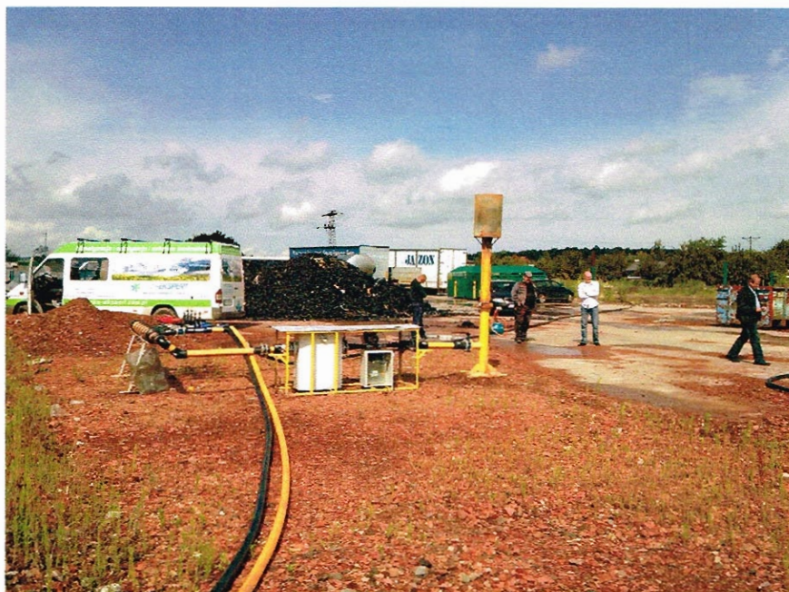
Fotografia nr 1. Instalacja badawcza z pochodnią
