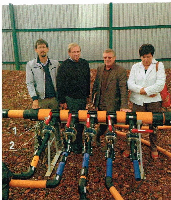
Fotografia nr 2. Instalacja badawcza – kolektor zbiorczy 1 – zasuwa regulacyjna 2 – króciec pomiarowy
