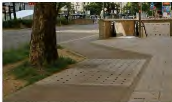
Zdjęcie 19 Płyta betonowa w ciągu drogi dla rowerów nad korzeniami drzewa. Niemcy
