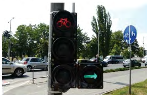
Zdjęcie 50 Sygnalizator S-1a z warunkową strzałką do skrótu w prawo – sygnalizator na końcu kontra pasa rowerowego zapewnia relację niedostępną dla ruchu samochodowego
