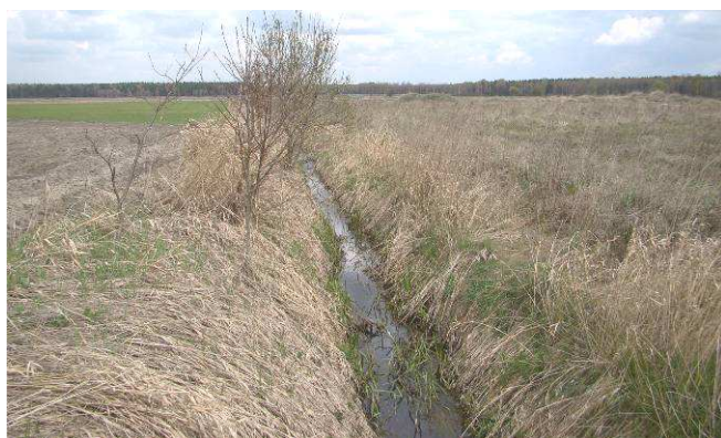
Rowy odwadniające, droga polna
