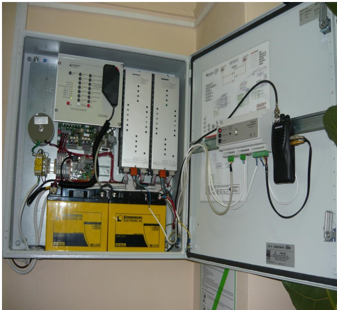
Syrena alarmowa EWSA 4 – wnętrze urządzenia alarmowego
