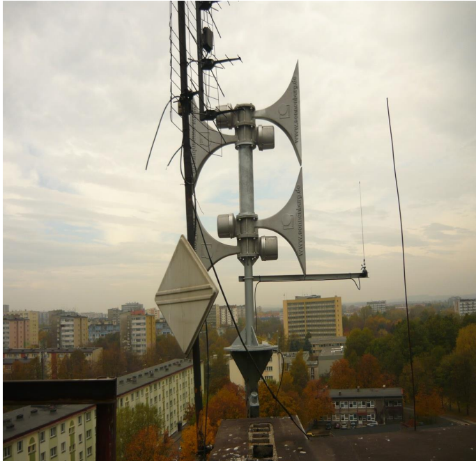
Syrena alarmowa EWSA 4 – głośniki na dachu budynku mieszkalnego
