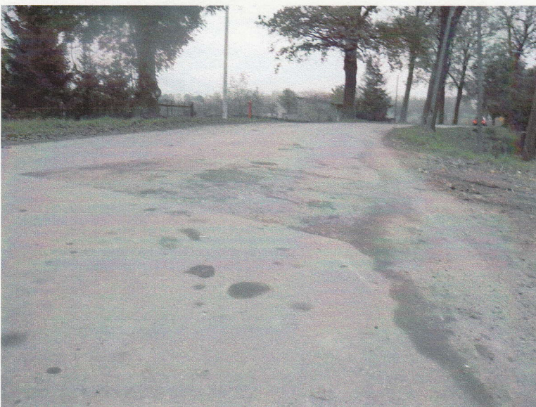
Foto nr 4 ul. Mysłowicka – garb na jezdni.
