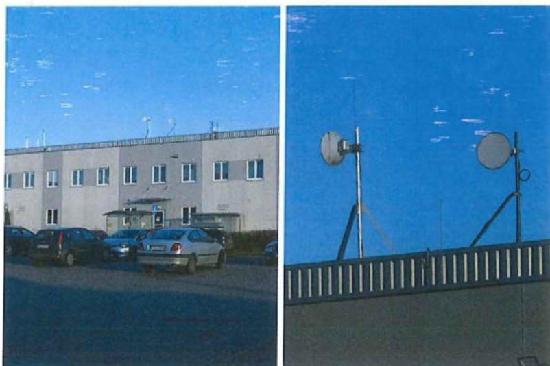
Widok obiektu wraz z zainstalowanym zespołem antenowym
