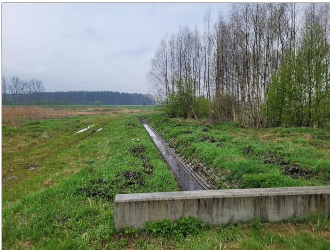
FOTOGRAFIA 3. DRUGI Z KANAŁÓW ŚCIEKOWYCH – WYPEŁNIONY WODĄ – KORYTO W BETONOWYCH PŁYTACH AZUROWYCH
