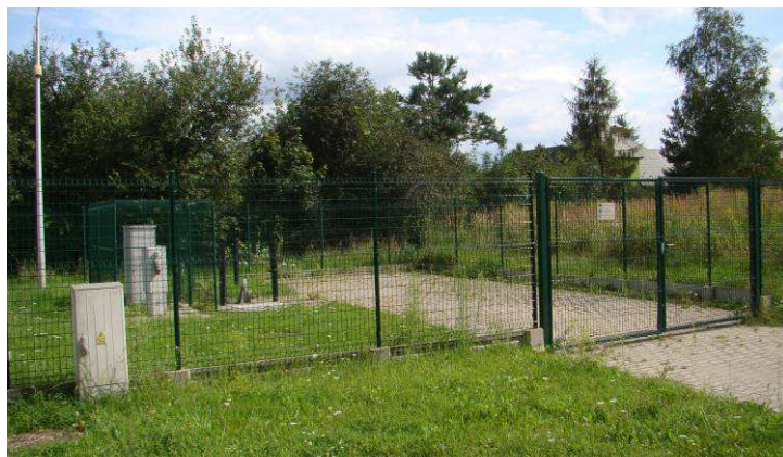
Pompownia ścieków sanitarnych znajdująca się blisko południowej granicy terenu
